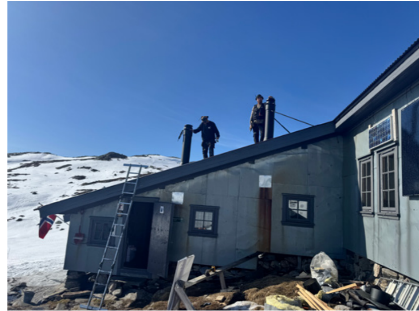
Heibergtunet Storevatn har fått nye ovner og piper.
