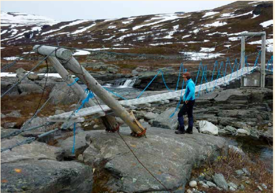
Hengebrua ved Rostahytta før reparasjon. Foto: Roy Andre Lyså
