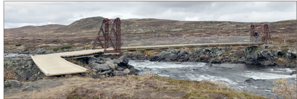
Ferdig bru! God klaring til flomvannet, pen krumning oppover på en slank brubane, gjenbrukte fagverkstårn av stål, skikkelig rekkverk
